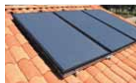
Capteurs posés sur le toit Tuiles
