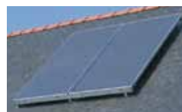
Capteurs posés sur le toit Ardoises
